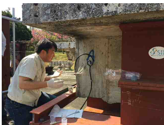
写-4-4 モニタリング用塩分センサ設置状況
