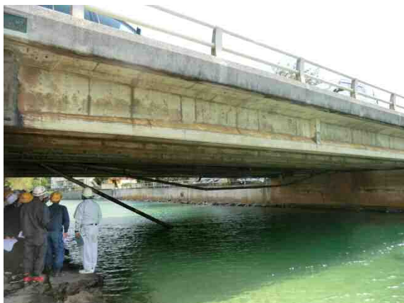
写-1-3 M橋塩害劣化視察状況
